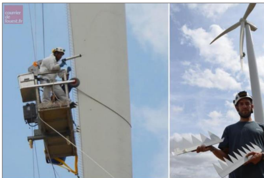
Figure 4 : Installation de serrations sur le parc éolien de Boralex de Coulonges, le courrier de l'ouest, 2016
